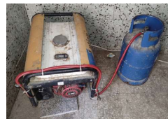
電気がないため、危険を伴いながらもガスを使って自家発電している
