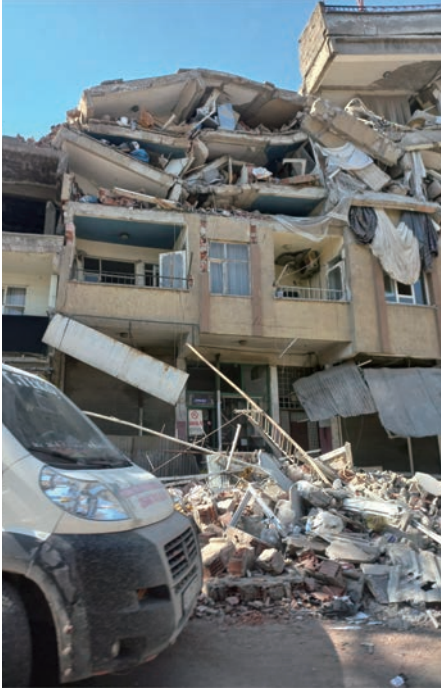
地震により崩れたビル(トルコ・カフラマンマラシュ県)
