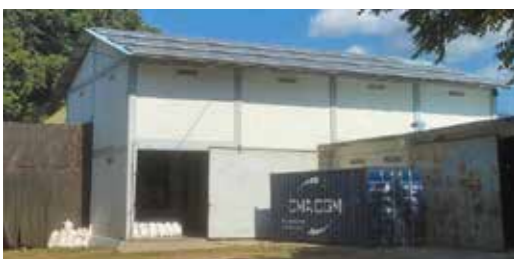
事例(2次加工場の屋根の上に設置されたソーラーパネル)
