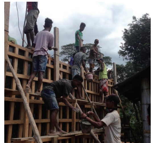
20立方メートルの貯水タンクにセメントを流し込む作業
